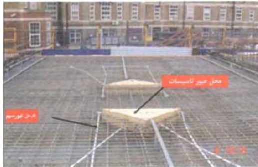
شکل ۲-۲۸- عدم محل نصب قوطی کلدها در قسمت تجمع میکروکرک
